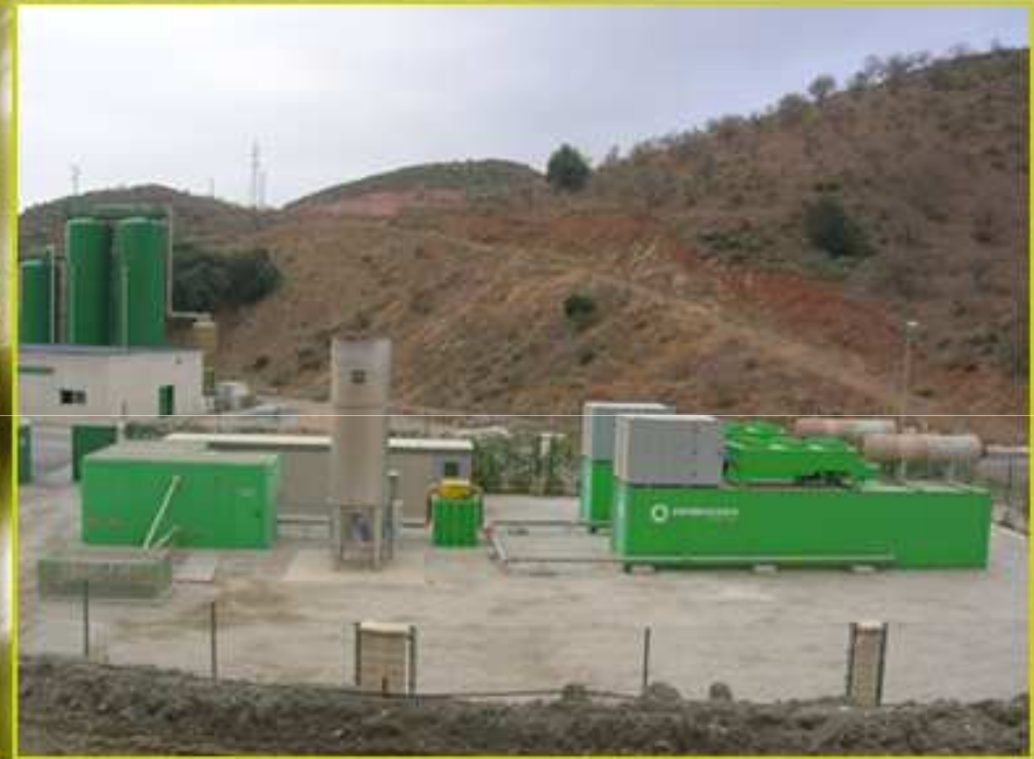
:: Planta de Desgasificación y Aprovechamiento Eléctrico ::
