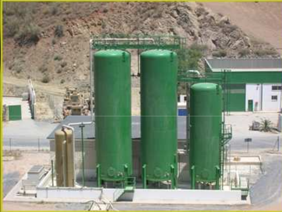
:: Planta de Tratamiento de Lixiviados ::
